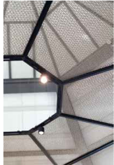
Abgehängte Decke mit Netzgewebe © Onmind GmbH/Gruschwitz GmbH
